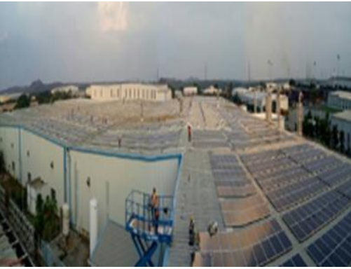
Phase 2 : 5 MW TKM Roof Top
